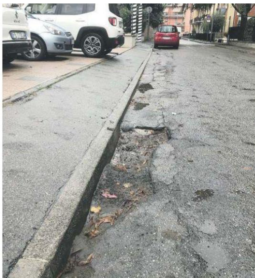
Un'immagine di repertorio di un tratto di strada dissestata
